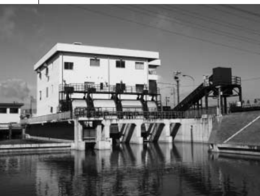
最近の代表的実績の一つである弁天排水機除塵設備（愛知県刈谷市発注、平成16年度納入）
