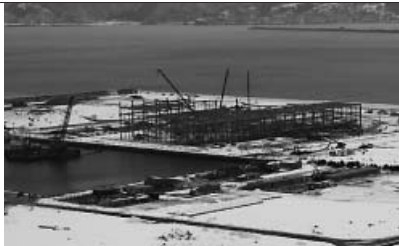
建設中の久慈新工場。ブロック加工専用工場で操業開始は5月の予定(写真は2月上旬時)
