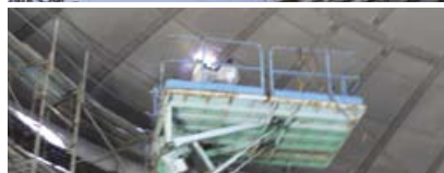
(上) 屋根部分の部材がクレーンで搬送され、(中) 側板部分に取付けられる。(下) 屋根部分は二重になっている。写真は内面屋根板の溶接を高所作業車に搭乗した作業員が進めているところ。
