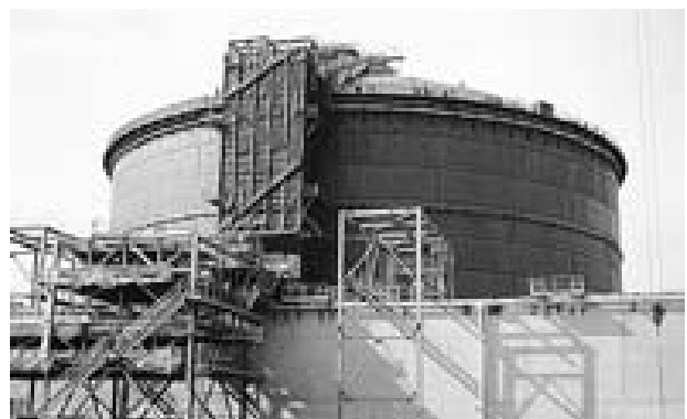
図4 地上式 LNG タンク外觀
