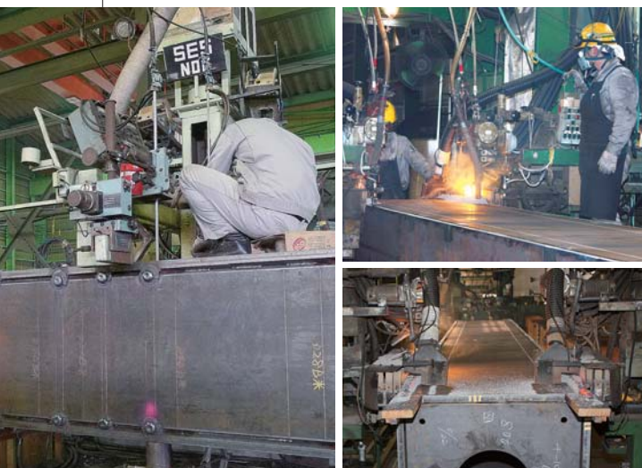
(左) SESNET 溶接機による溶接状況。現在12基が稼働している。溶材は◎YM-55HF×◎YF-15I。 (右上・右下) ボックス柱かど溶接装置による溶接状況。溶材は◎Y-DL×◎NSH-53Zのほか、◎Y-DM3L×◎NSH-60Sなど、物件に応じて使い分けがなされている。
