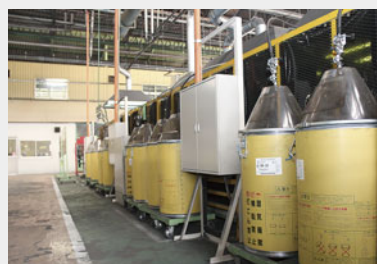
バンパービーム溶接組立ラインでご採用いただいている
