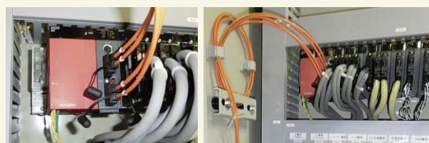
工場で MELSEC に使用されるピコケーブルの使用例写真
