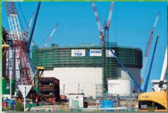
撮影協力／トーヨーカネツ(株) 股 中部電力(株) 股(上越火力発電所 No.3LNGタンク建設現場)
