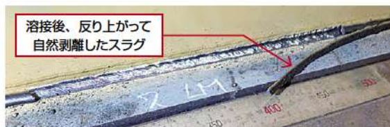
写真1 グラビティ溶接時のスラグ剥離状況(プライマー塗布鋼板)
