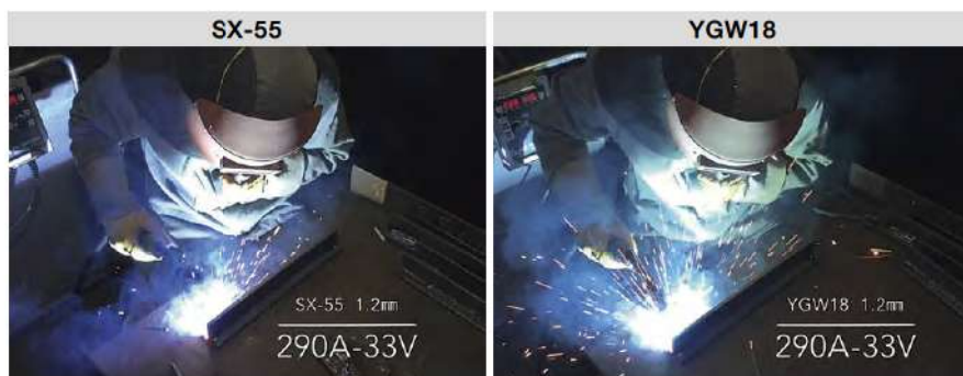
写真 1 | スパッタ発生状況
